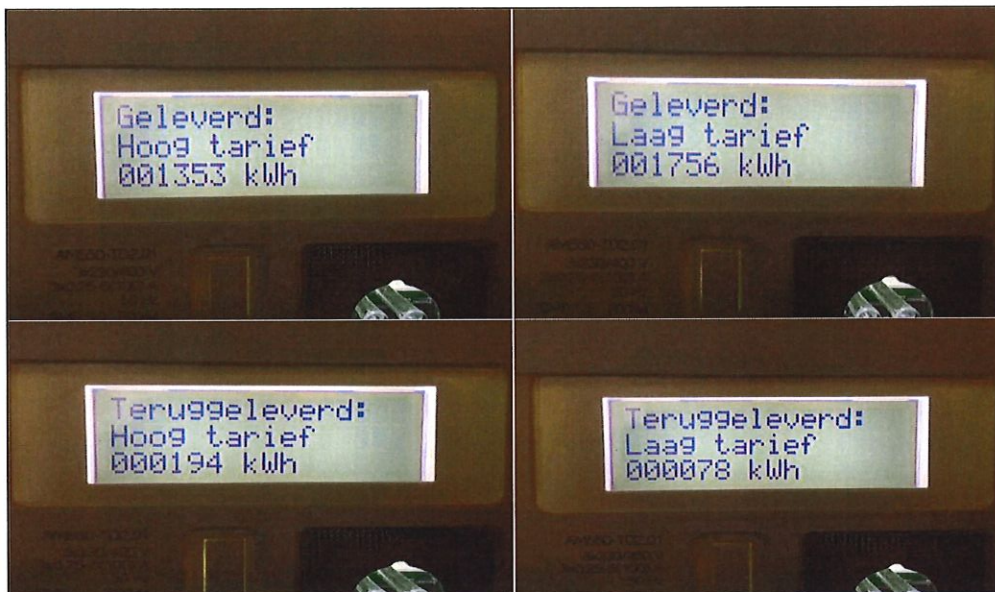
Foto meterstanden inverter.
