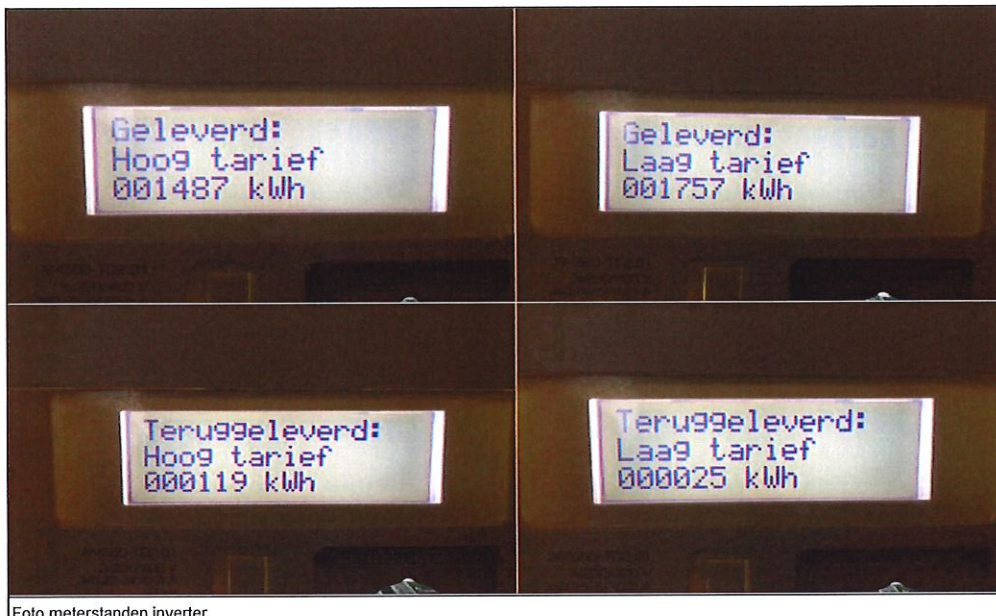
Foto meterstanden inverter.
